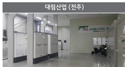
PCS : 1MW / 배터리 : 2MWh 부하 이동용
