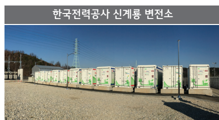
PCS : 24MW / 배터리 : 6MWh 주파수 조정용
