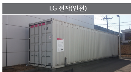
PCS : 4MW / 배터리 : 1MWh 주파수 조정용
